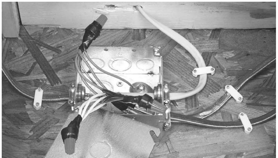
Caja de empalmes con múltiples conjuntos de cables de corriente de la placa, conectados en paralelo, y conectados al suministro de electricidad.
